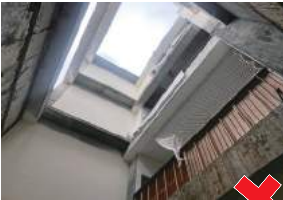
天井欄杆未確實固定
